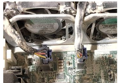
Baustaub in Lüftern
